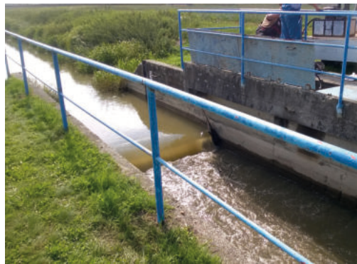
Billenőtáblás elzáró szerkezetű, olajhidraulikus, kötéletes mozgatású műtárgy, Keszeg-ér duzzasztó, Zsebeháza
