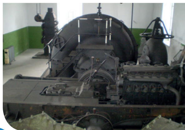
9. kép: Egybeépített diesel motor, váltó és a szivattyú
